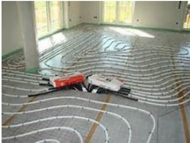
Technische Beispielaufnahme: flächige Fußbodenheizung.
